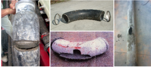
輸送管の破裂
