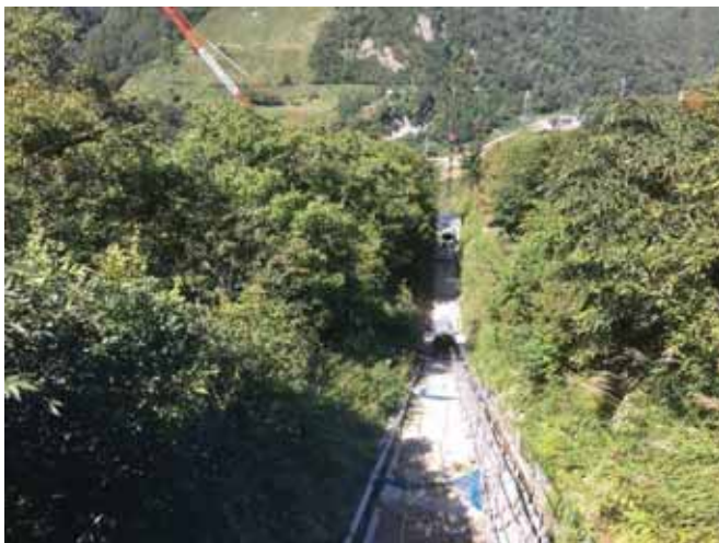
写真－6 打設箇所手前の配管
