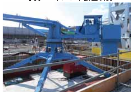
写真2 ディストリビュータ設置状況
