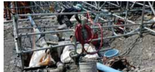
写真-2 残コンクリート処理タンク
