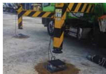
写真-2 ロードセルの設置状況
