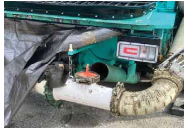
写真-3 T字管
