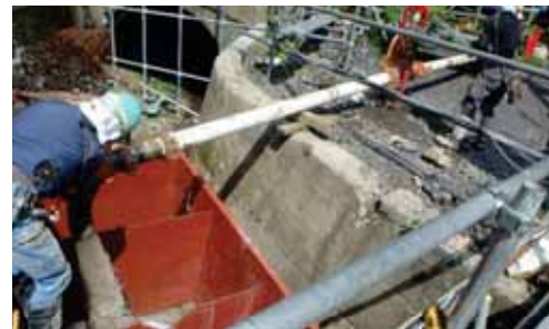
写真-1 排水処理タンク
