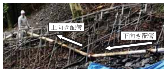
写真-3 閉塞多発箇所
