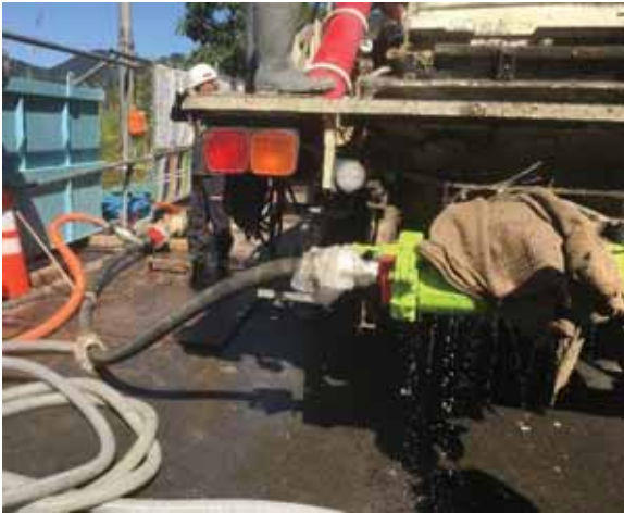
写真－5 水送り時の根本配管
