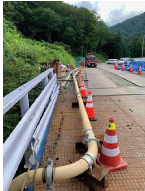
写真－8 圧送車付近の水平配管
