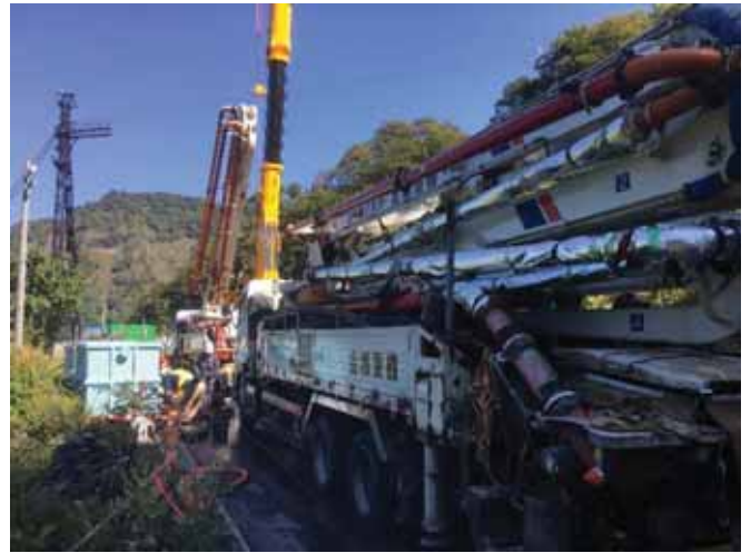
写真-3 同機種の縦列配置
