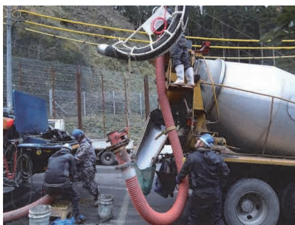
写真-4 残コンクリートをサクションホースで返送する作業の状況
