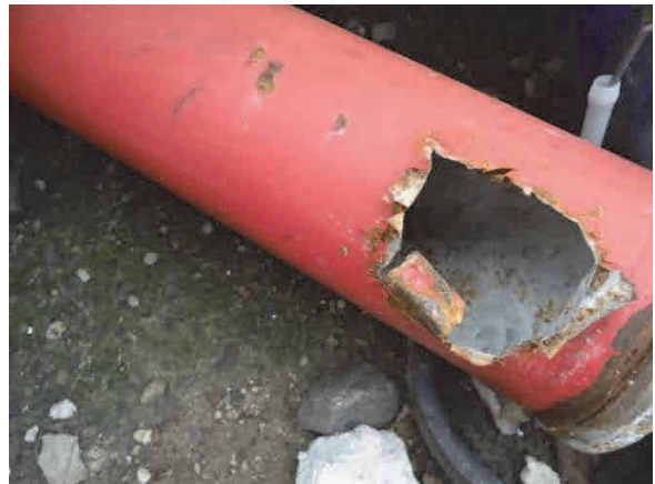
写真-3 配管の破裂
