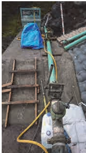
写真-1 油圧ロータリーバルブの様子
