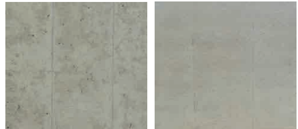
i) 円形ホース ii) 扁平ホース 写真-10 コンクリート表面の出来栄えの比較
